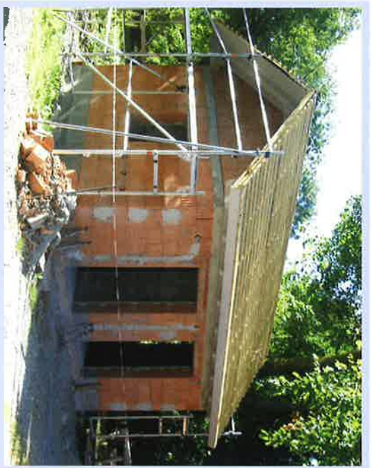
► Öffentliches WC-Häuschen mit Technikraum am Dorfplatz Unterrieden
