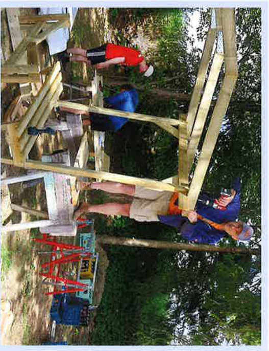
► Rastplatz für Fußgänger und Radfahrer mit Ladestation in Oberrieden
